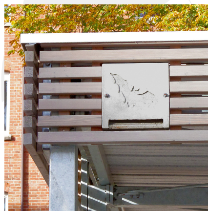
▲ Fledermauskasten aus Holzbeton in Ulm.
